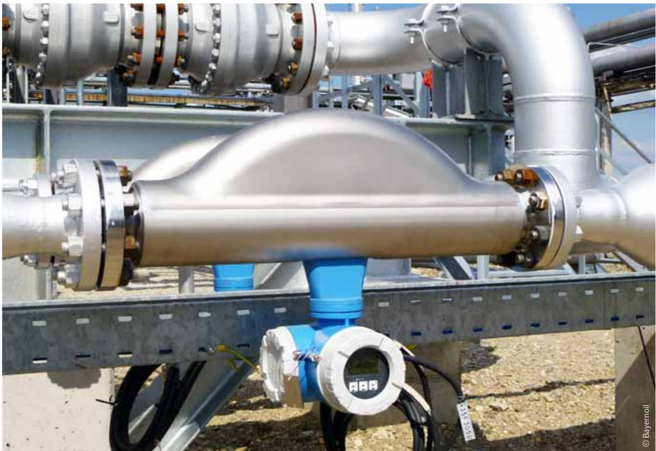
Bayernoil setzt auch bei der Durchflussmessung von Raffineriegas auf die hochgenauen und zuverlässigen Endress+Hauser Proline Promass 84 F.
