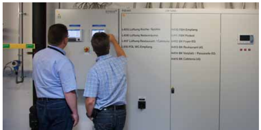
Die Messdaten werden auf fest installierte Datenlogger übertragen.
