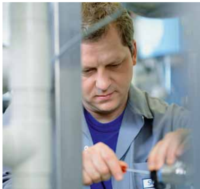
Sensible Infrastruktur: Instandhaltungs-Ingenieur René Zeidler prüft ein Druckmessgerät an der Wasseraufbereitungsanlage.
