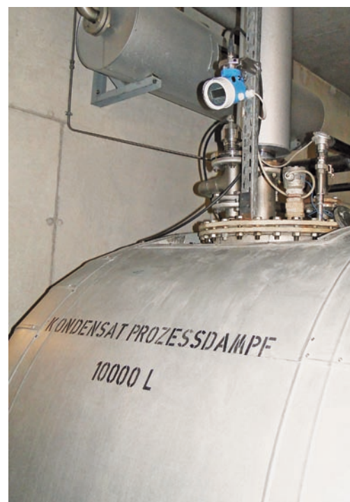
Kondensatbehälter bei der Brennet AG mit eingebautem Levelflex FMP51 zur Füllstandmessung
